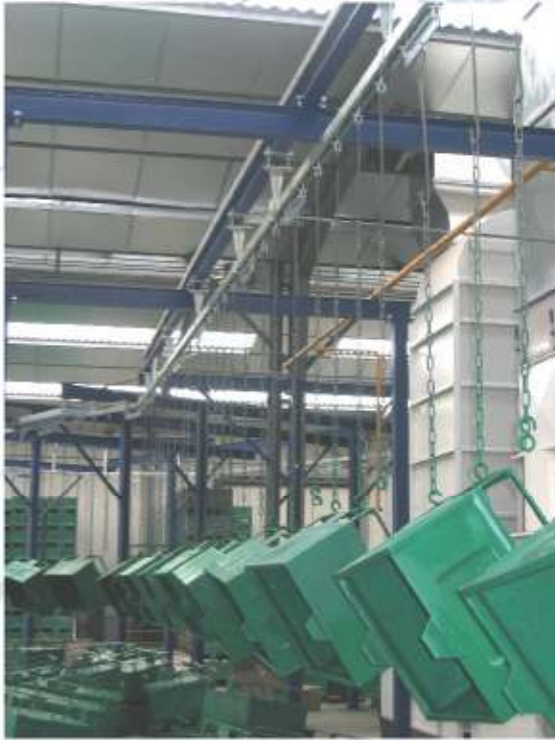
Transportador con cadena (Línea de pintura)
