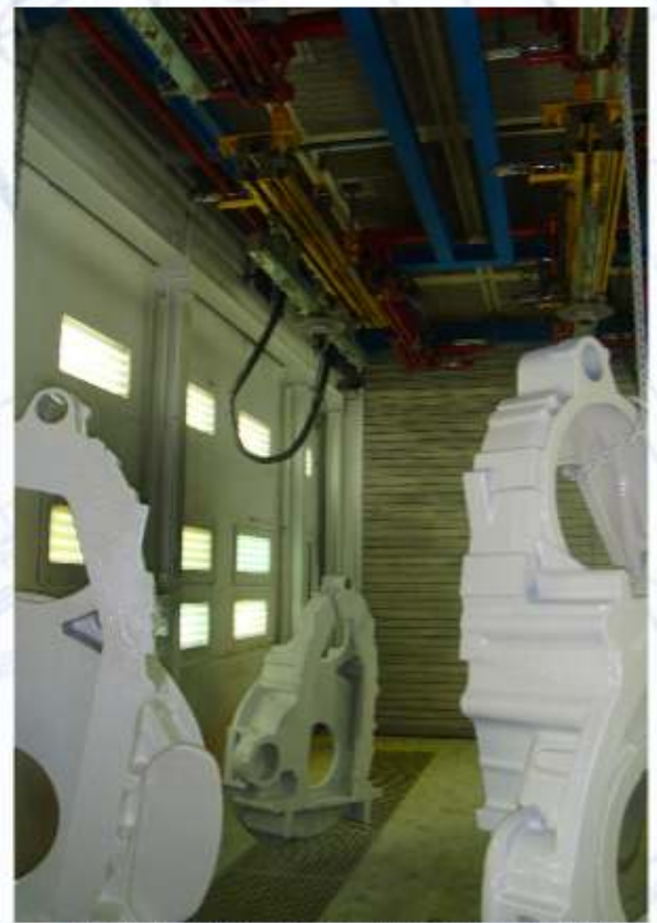
Elevadores integrados en la cabina de pintura
