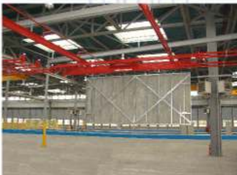
Transbordadores con vigas rodantes
